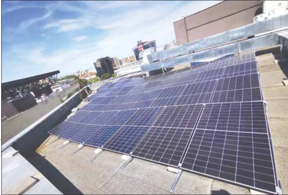
Hotelul Univers, dotat cu 160 de panouri fotovoltaice
