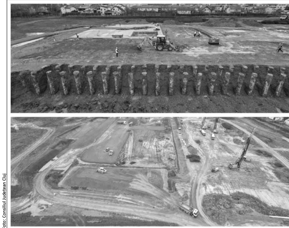
Lucrările pentru edificarea celei mai moderne unități spitalicești din România – Spitalul Pediatric au demarat în forță
